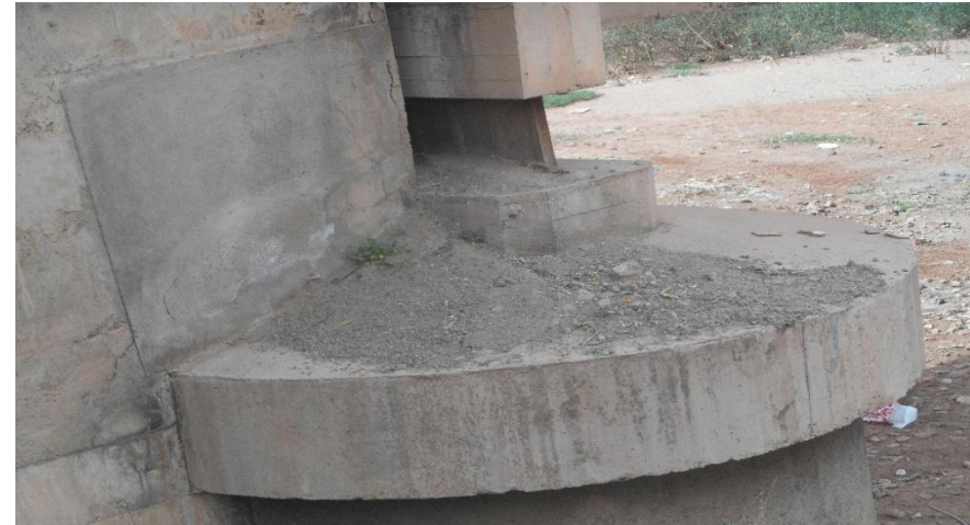
Appareils d'appui métallique à balancier avec pendule au niveau des culées
