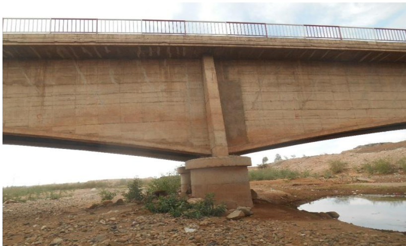
Fissuration importante au niveau des poutres
